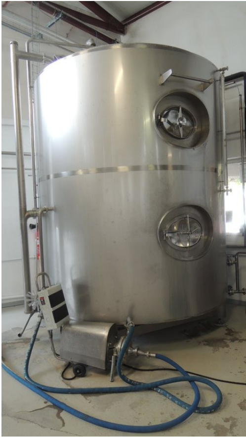
Cuve Whirlpool et cuve d'eau chaude au-dessus :
