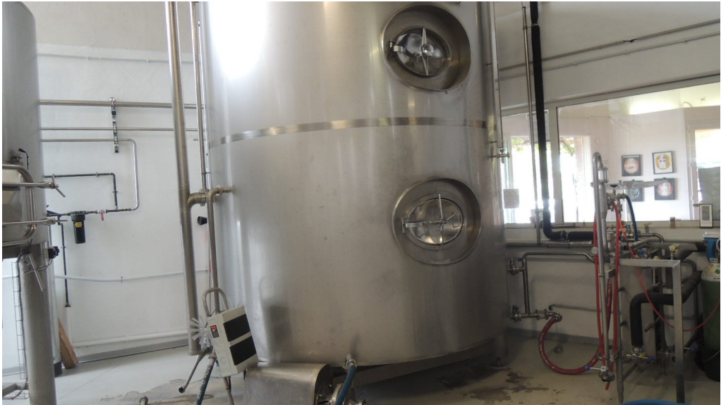
Cuve Whirlpool et cuve d'eau chaude + Echangeur de température et oxygénateur :
